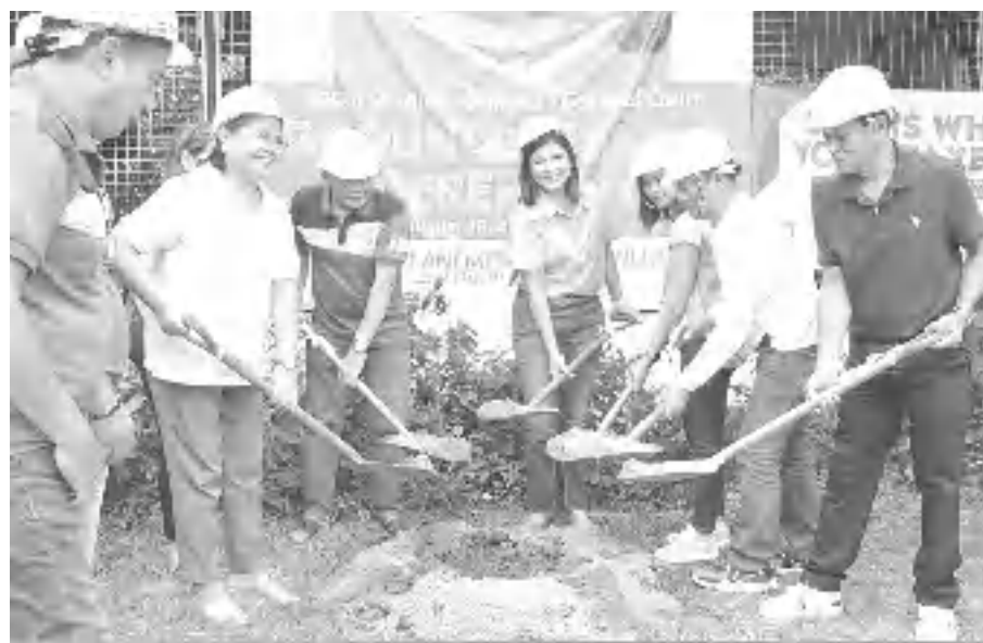
Ilang panahon na lang at magkakaroon na ng bagong covered court ang mga taga-South Susana, Molino 2. Ipinagdiwang na po ni Cong. Lani Mercado-Revilla ang groundbreaking para dito kamakailan, kasama ang kanilang mga barangay officials, homeowners association officers, at residents. Sama-sama po nating pinangarap ito, at tulong-tulong po tayong lahat hanggang sa katuparan nito. Congratulations at maraming salamat sa inyo!
