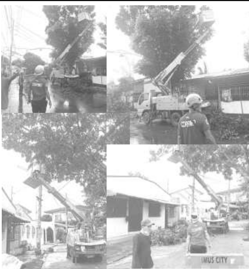
Sa pakikipagtulungan ng City Engineering Office at City Disaster Risk Reduction and Management Office (CDRRMO), pinutol kahapon, Agosto 23, ang sanga ng mga puno na maaaring magdulot ng panganib sa mamamayan.
