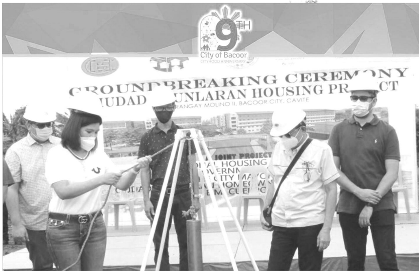
Noong June 9 ay ginanap ang groundbreaking ceremony para sa Ciudad Kaunlaran, ang in-city resettlement site para sa informal settler families na makakasama sa relocation na dulot ng coastal easement ng Bacoor Bay. Inaasahang magkakaroon ng 1,800 units sa 4-storey medium rise buildings sa Ciudad.
